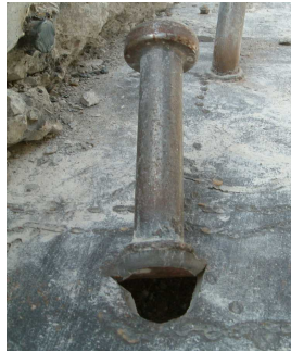
図4 底鋼板がめくれたスタッド
